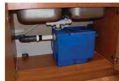
Mobil zsírlevasztó mosogató alá beépítve.
