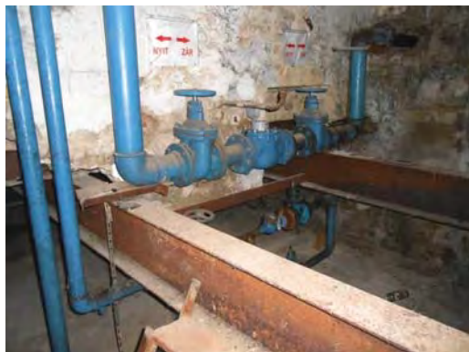
Épület vízbetáp és vízmérők
